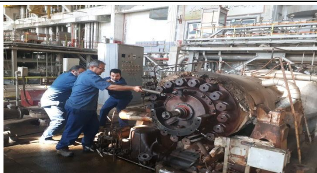
اورهال پمپ توربو فید پمپ واحد ۶
